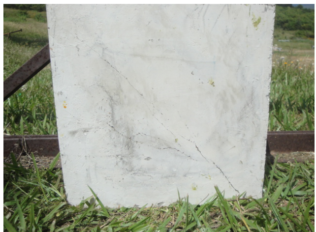
Cara posterior SIN DAÑO
